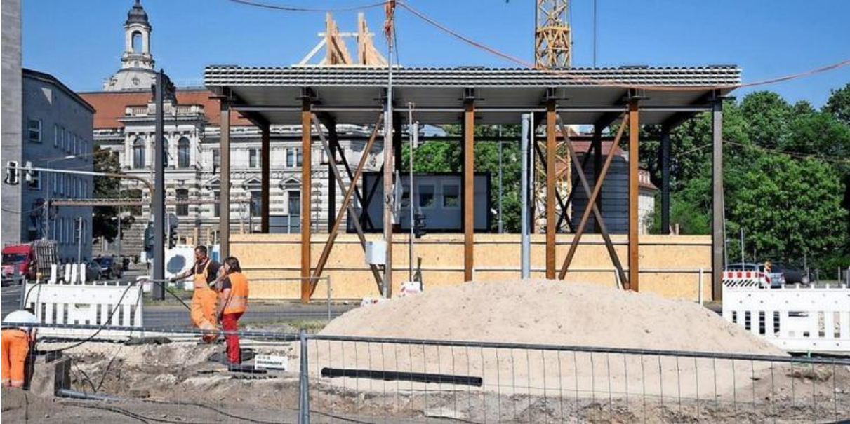
Das schuppenähnliche Gebilde schützt Fahrleitungen, Gleise und Straßenbahnen. Quelle: Anja Schneider
